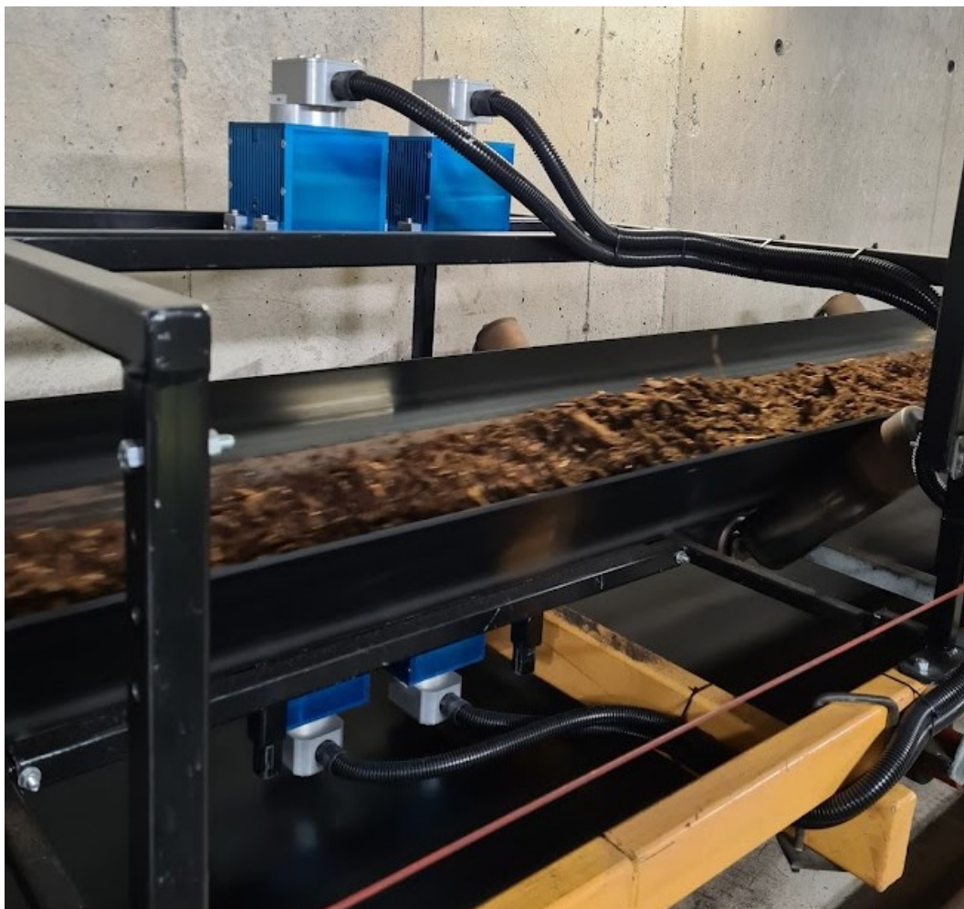
Figur 5. Mätanordning för kontinuerlig mätning på transportband. Foto: Daniel Andersson, Radarbolaget
